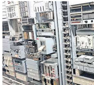
Spannende Technik: Das Bild zeigt einige Baugruppen für den Service der großen Ortsvermittlung.
